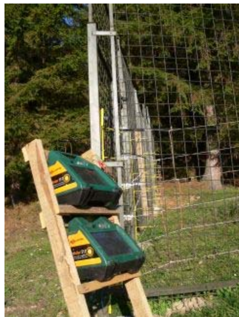
Fig. Nr 4 Echipamente ale sistemului electrificat care dublează împrejmuirea metalică a modulelor de monitorizare secundară (țarcul) M2
